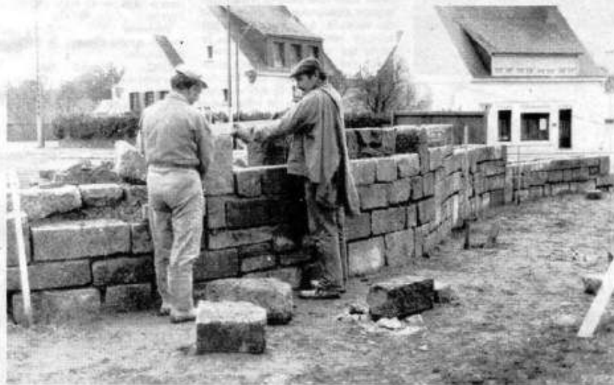
Les employés communaux construisent le muret évocateur de la Ville-close, au rond-point de Kerviniou.
